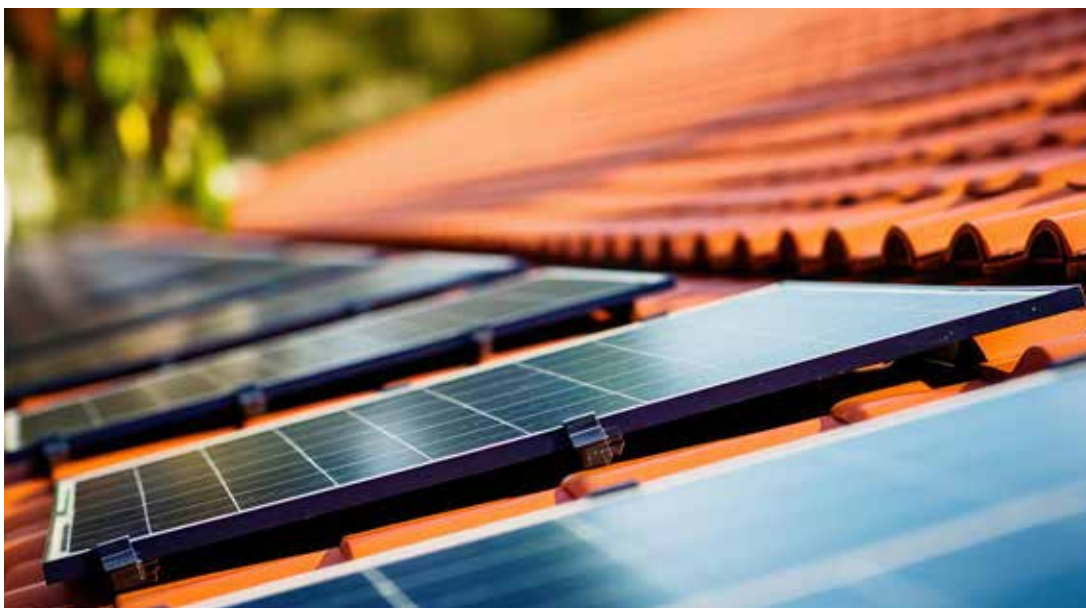
Zonnepanelen op dak (cherezoff, Adobe Stock)
